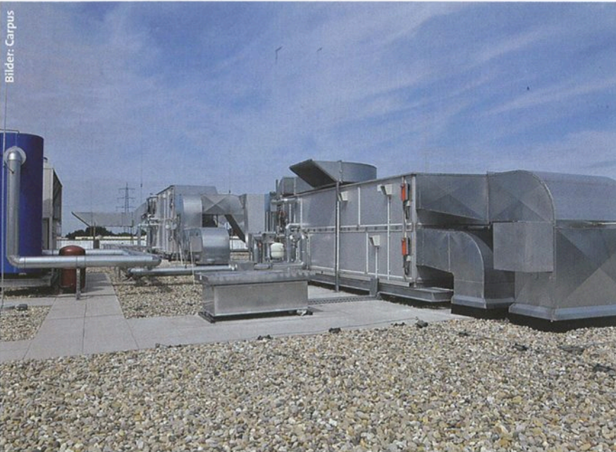
Klimazentralgerät für aseptische Produktion
