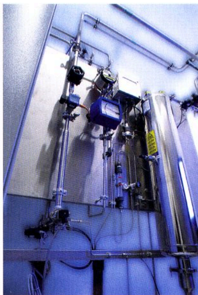
Abb. 3: Ozon- und UV-Nachbehandlung sorgen dafür, Aqua purificata kontinuierlich keimfrei zu halten und bieten zusätzlich Schutz für das Ringleitungs- und Tanksystem.
